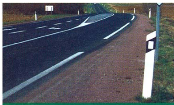
Figure 3.5 – Image de délinéateurs (balise J6), balisage des limites de la chaussée.
