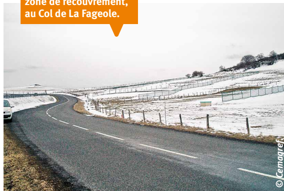
7 Barrière à neige placée trop près de la chaussée.
