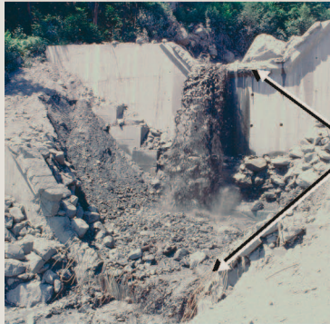
Impacts des blocs
