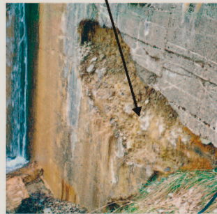
Dégradation du béton
