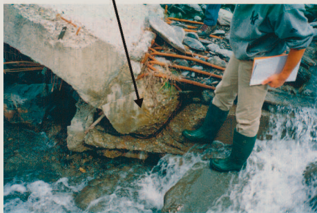
Rupture totale (encastrement voile-semelle)
