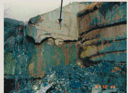
Fissuration d'une aile
