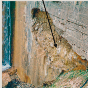
Dégradation du béton
