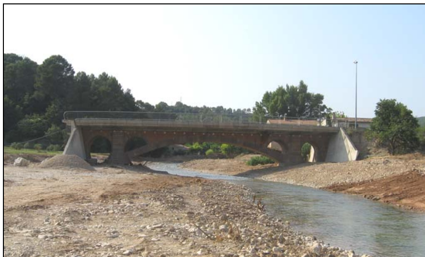
Photo 5 - Taradeau : le pont de la RD10 après la crue. Le remblai de rive droite a été déblayé. À noter la faible section offerte par le pont au passage de l'eau (voir Photo 6).
