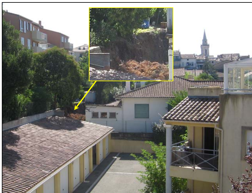
Photo 19 - Draguignan : l'immeuble "Les Floralies" (jaune) et une habitation du "Clos Jean Aicard" (blanche) vus du canal de la Riaille : les eaux venant de la rue de Montferrat ont défoncé le mur de séparation entre l'immeuble "Les Magniolas" (en haut à gauche – lui-même touché) et le Clos Jean Aicard. [cliché : C. MARTIN, août 2010]
