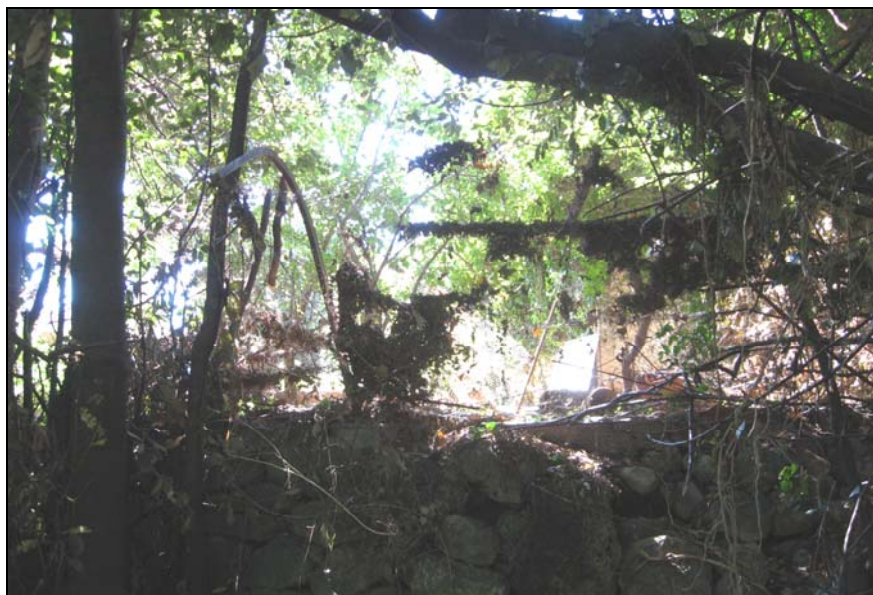
Photo 33 - Figanières : laisses de crue dans un grillage au-dessus du lit du ruisseau de la Tuilière près de l'entrée dans sa section couverte. [cliché : C. MARTIN, août 2010]
