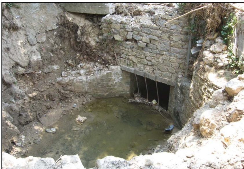
Photo 15 - Draguignan : l'entrée du ruisseau de la Riaille dans sa section couverte au bas du Malmont. [cliché : C. MARTIN, juillet 2010]
