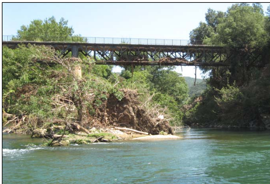
Photo 14 - Le pont de fer à la confluence de l'Argens et de l'Aille. En moyennes eaux, l'Argens décrit ici un coude et passe deux fois sous le pont ; l'Aille arrive de derrière le photographe, à droite. À noter les laisses de crue dans la structure du pont et le gros arbre déraciné au premier plan. [cliché : C. MARTIN, juillet 2010]
