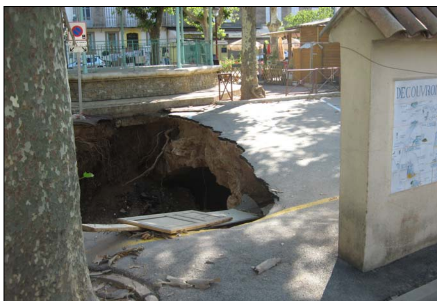
Photo 10 - Les Arcs-sur-Argens : le trou apparu sur la place de la mairie. Il a commencé de se former pendant l'épisode, sous l'effet de la pression à l'intérieur du tunnel. L'effondrement de la voûte s'est produit ensuite. [cliché : C. MARTIN, juillet 2010]
