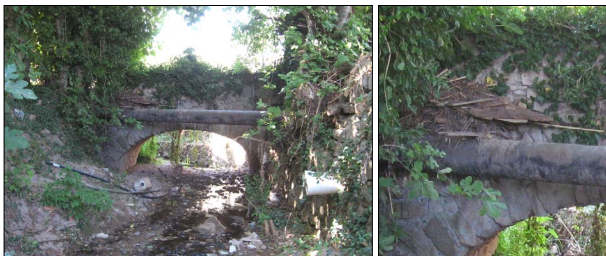
Photo 30 - Vidauban : pont sur un affluent de l'Argens. L'agrandissement à droite permet de mieux voir les branchages déposés au dessus du tuyau contre le pont. [cliché : C. MARTIN, août 2010]
