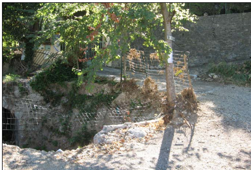
Photo 16 - Draguignan : le ruisseau de la Riaille au bas du Malmont : à gauche, un ancien pont (maintenant colmaté, qui ne laisse plus passer que les basses eaux), à droite (en rive gauche du ruisseau) une grille basculée et des laisses jusqu'en haut d'un grillage. [cliché : C. MARTIN, août 2010]
