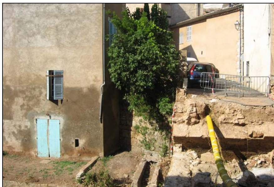
Photo 9 - Les Arcs-sur-Argens : le Pont-Vieux à l'amont de la place Paul Simon. Le tablier a été endommagé par la crue, mais plus encore lors des opérations de dégagement. La fenêtre à gauche de la photo porte un repère de crue artisanal.
