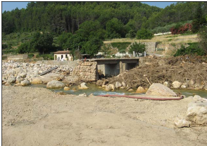
Photo 21 - Le pont de Rebouillon : la Nartuby a creusé un nouveau lit, en rive gauche. [cliché : C. MARTIN, juillet 2010]
