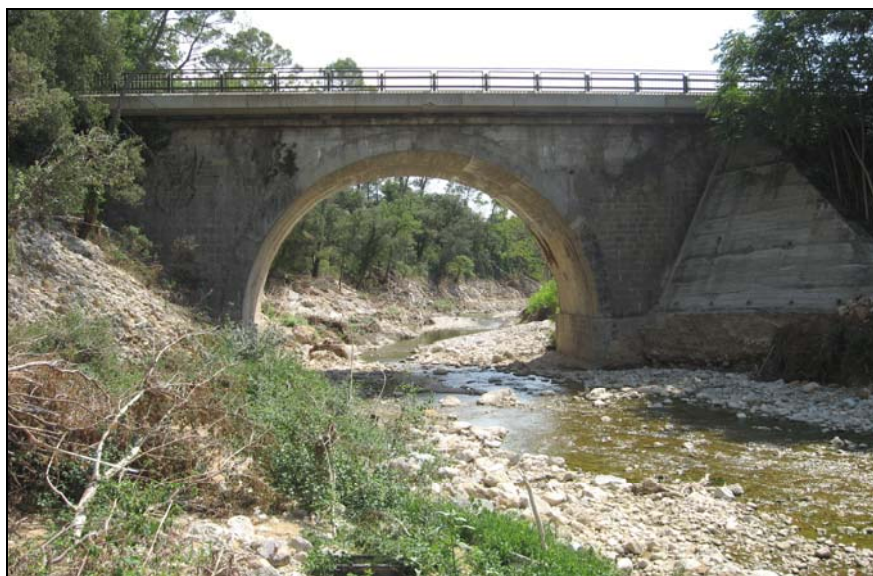
Photo 6 - Le pont de la RD562 sur la Florièye : la rivière a emporté la ripisylve et élargi son lit. Avec un niveau moyen de 4,5 m environ, elle était loin d'utiliser toute la section offerte par le pont (largeur : 13 m – pente longitudinale de l'ordre de 1 %).
