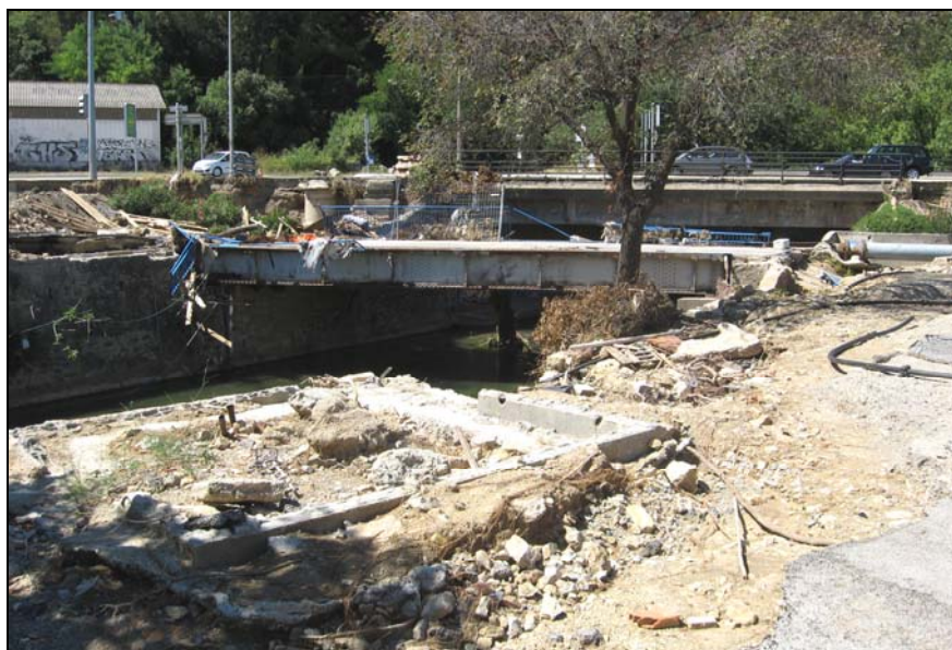
Photo 37 - Trans-en-Provence : le pont de la RD1555 et la passerelle située en aval, après la crue.
