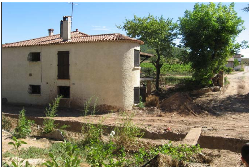
Photo 29 - Les Arcs-sur-Argens : une habitation dans le lit majeur du Réal, au-dessus de la section endiguée. Les eaux ont envahi le premier étage. [cliché : C. MARTIN, août 2010]
