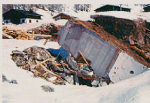
Habitation détruite (MontRoc, Chamonix, France)
