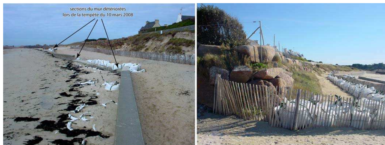
Photo 1 – Deux sections de mur qui ont été détériorées lors de la tempête du 10 mars 2008. Les bigbags ont été posés en avant du mur pour le maintenir alors qu'il avait été mis en porte-à-faux par l'érosion des sables du haut de plage. Dans le même temps, des bigbags et des ganivelles ont été posés un peu plus haut en pied de dune pour le protéger (clichés Suanez et Fichaut, 25/02/2009 et 30/03/2009).
