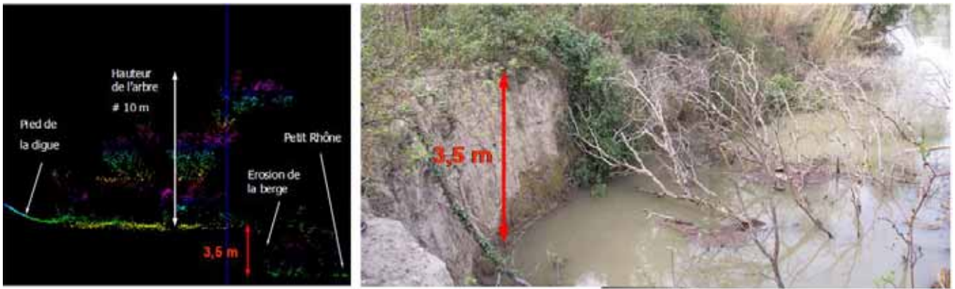
Figure 1 : Effondrement de berge à proximité du pied de digue (1) caractérisée sur le profil en travers laser (2) vue in situ. Ce désordre apparaît clairement bien que masqué par la végétation.
