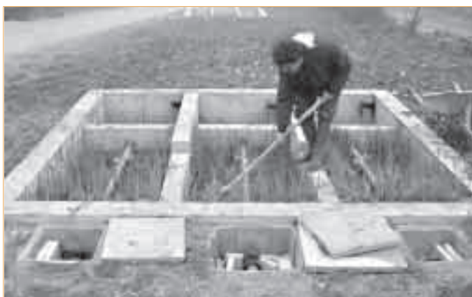
▼ Photo 1 – Vue générale des filtres du 1 er étage dans une ferme de Côte-d'Or.
