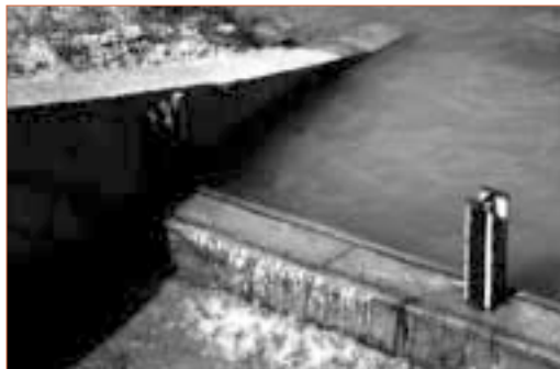
Photo 7. – Barrage de Saint-Maur. Rehausse du seuil déversant par une poutre en béton. Remarquer les fers en H fixés aux bajoyers et destinés à la mise en place d'une rehausse amovible supplémentaire. ▶
