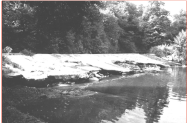
▲ Photo 3. – Seuil à profil triangulaire conforté sommairement par une chape de béton - dégradation du confortement sous l'effet des sous-pressions.
