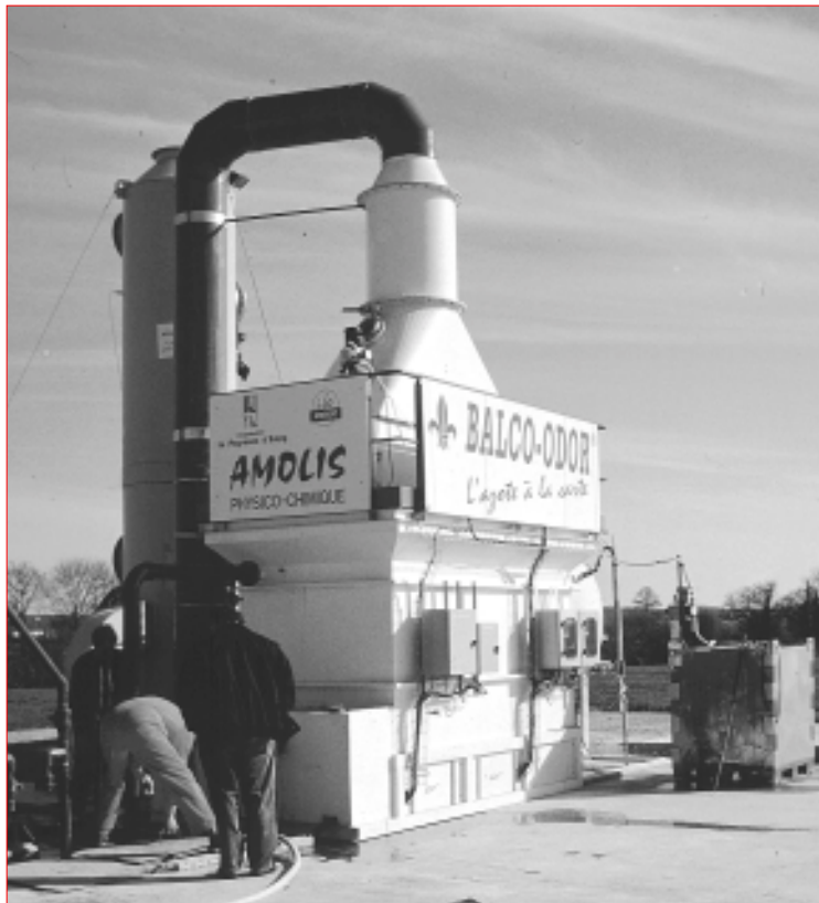
▲ Photo 5. – Volatilisation lavage acide de l'azote ammoniacal - procédé amolis physico-chimique (J. Coillard, Cemagref).
