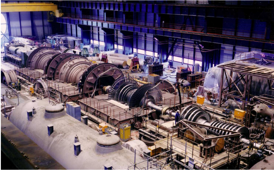
FIGURE 1: A real power plant turboset. Courtesy of Électricité de France
