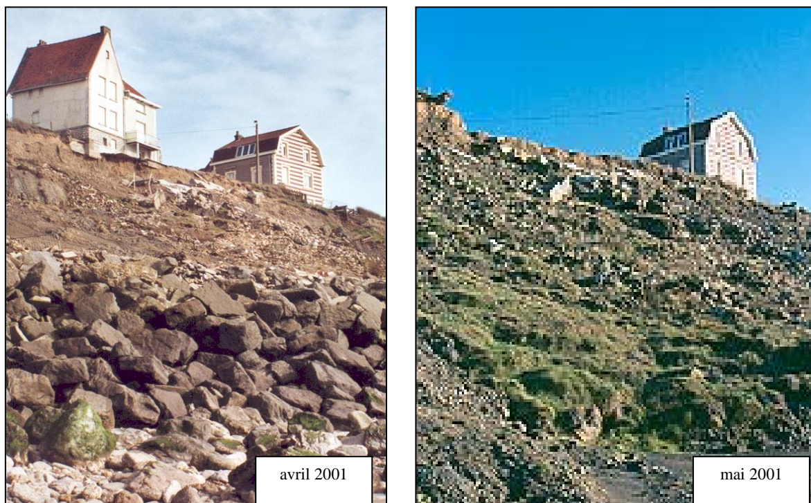
Figure 7 : Falaise nord de Wimereux où une maison qui menaçait de s'effondrer à dû être détruite en 2001.
