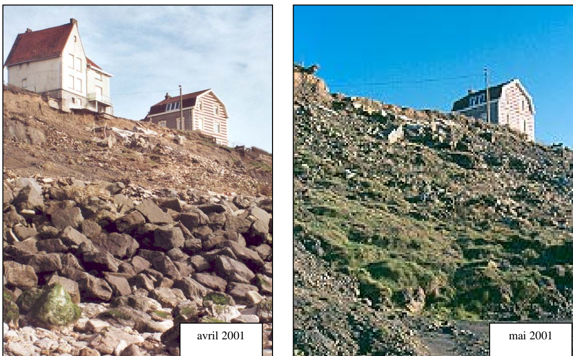
Figure 7 : Falaise nord de Wimereux où une maison qui menaçait de s'effondrer à dû être détruite en 2001.
