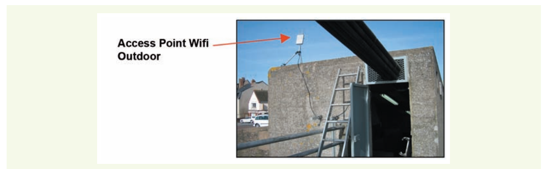
figure 9 Access Point Wifi Outdoor sur la chambre d'ancrage, i.e. dans le plan des câbles.
