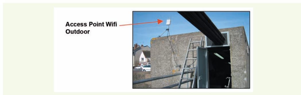
figure 9 Access Point Wifi Outdoor sur la chambre d'ancrage, i.e. dans le plan des câbles.
