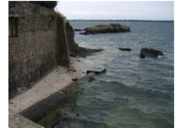
Evacuation des eaux à Concarneau
