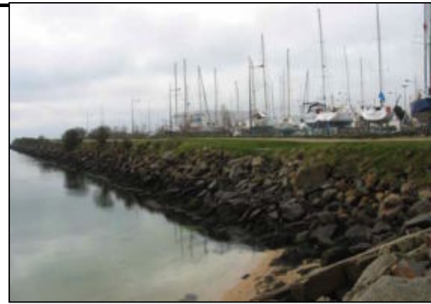
Enrochements du pourtour du polder à l'ouest du port de plaisance du Moulin-Blanc à Brest
