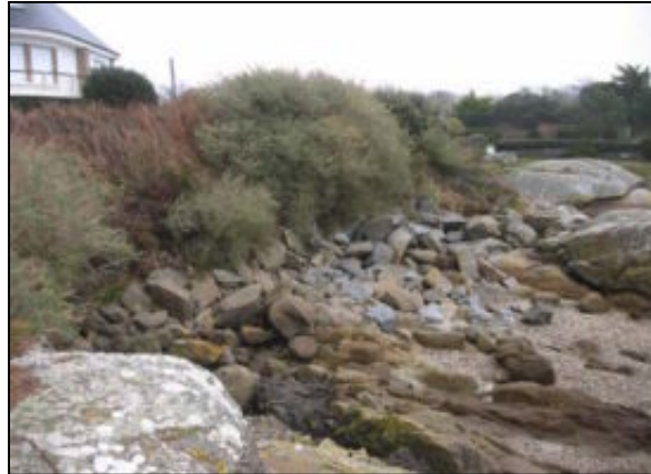
Enrochement non cohérent à Lanriec
