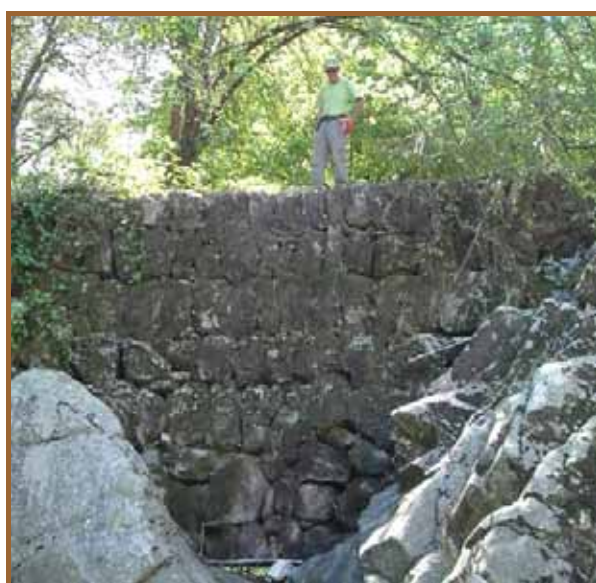
Photo 17 - Tancat sur le ruisseau de Valescure immédiatement amont de sa confluence avec le Gardon de Saint-Jean. (cliché : J.F. DIDON-LESCOT)
