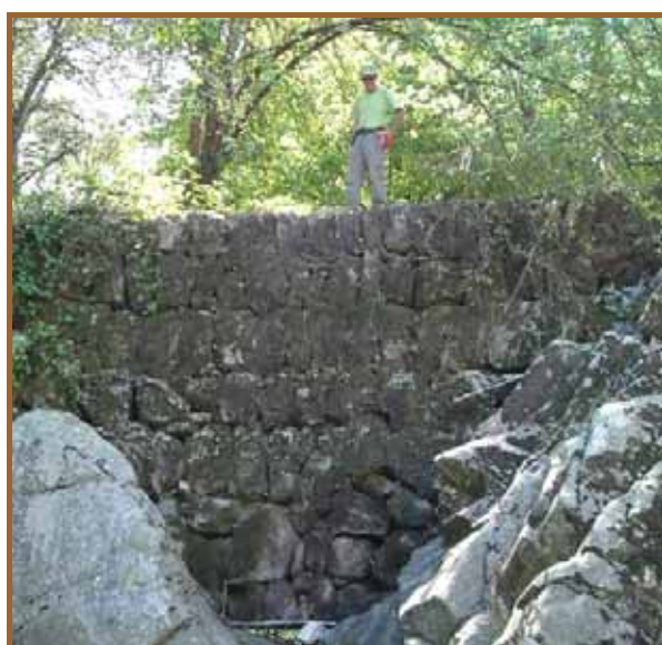
Photo 17 - Tancat sur le ruisseau de Valescure immédiatement amont de sa confluence avec le Gardon de Saint-Jean. (cliché : J.F. DIDON-LESCOT)
