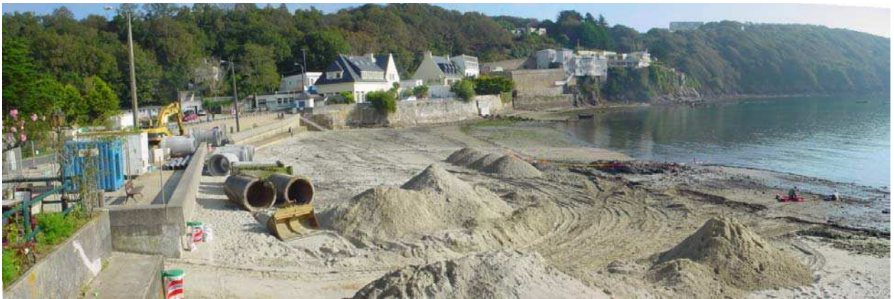
Figure 16 : travaux de rallongement de la buse du ruisseau de Sainte-Anne en octobre 2007
