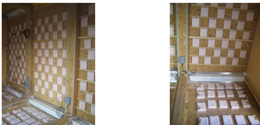
Figure 3: vue intérieure de la cellule test : 30% de la surface est occupée par des MCP pour les trois systèmes (à gauche) et pour un système (à droite).
