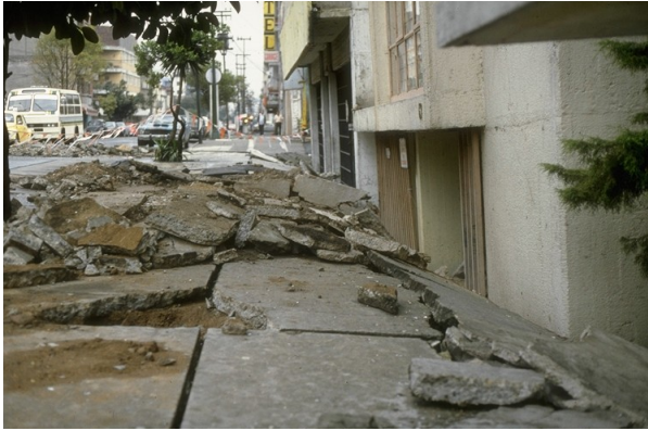
Figure 1. Rupture par perte de capacité portante après le séisme de Guerrero – Michoacán (Mexique, 1985).
