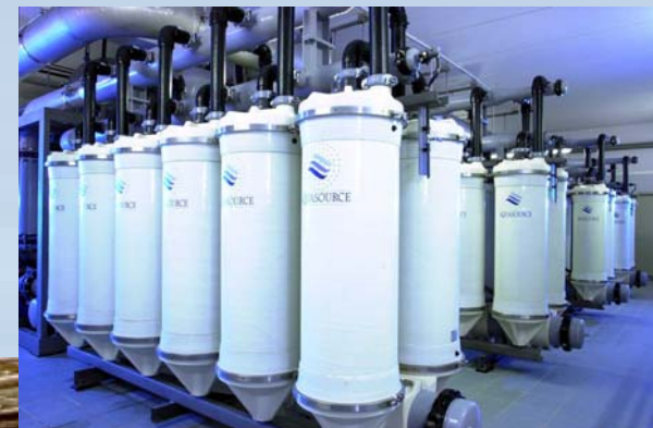
Station d'eau potable (24 000 m 3 /jour) de ROUEN avec 4*24 modules de 125 m 2 de surface. Mise en service 2000 (photo www.aquasource.fr )
