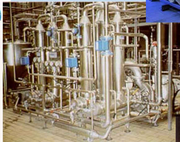
Unité de microfiltration pour le traitement de lactosérum
