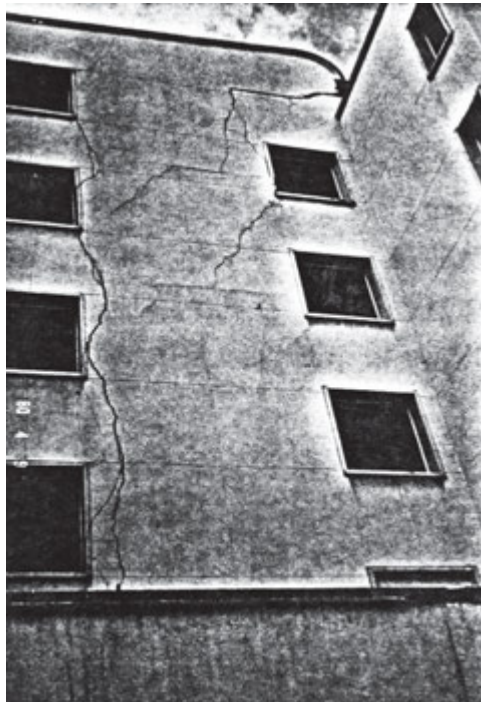
Figure 12. Fissures alarmantes apparues sur l'immeuble sinistré.
