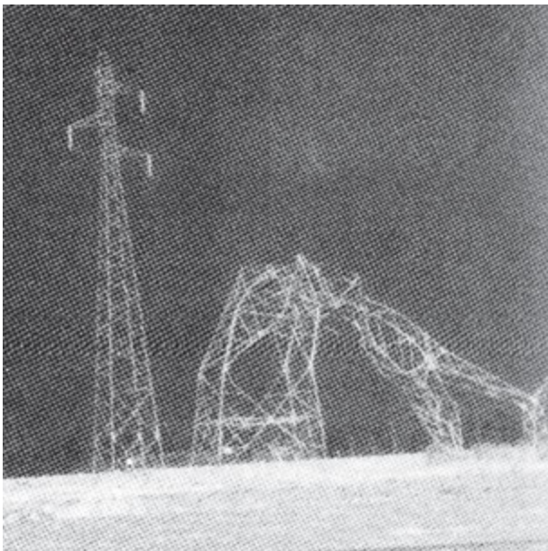
Figure 18. Pylône à haute tension en mal d'assise après la tempête du 25 décembre 1999.
