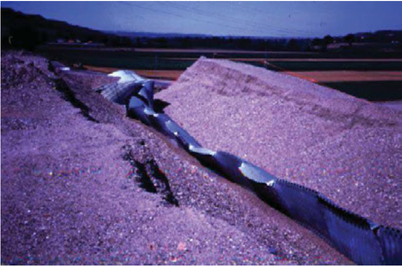
Figure 10. Buse métallique effondrée lors de sa construction sous une autoroute.
