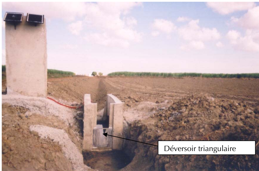
Figure 2. Bac déversoir pour le jaugeage des débits de ruissellement à l'aval de la parcelle gravitaire.
