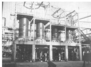
Réacteurs catalytiques à lit fixe utilisés pour le raffinage des crudes : on voit sur la photo quatre réacteurs en série, dans la même agencement de lit et séparés par les colonnes de purge. (Phonologie I.P.P. - Rousselle 1987)
