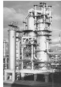
Réacteurs en lit fluidisé : on du chargement catalytique dans le réacteur R2M, la partie droite de l'unité correspond aux deux étages de régénération associés par l'ensemble des cyclones externes.
