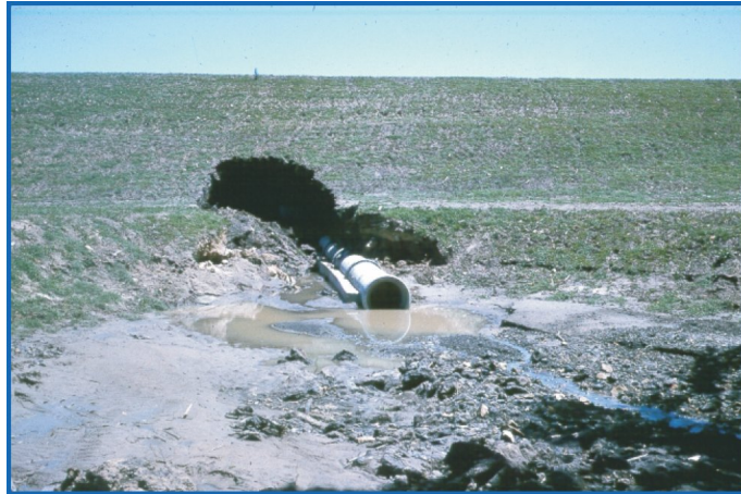
FIGURE 1.9 – Désordre causé dans un barrage en terre suite au développement d'un renard le long d'une conduite.
