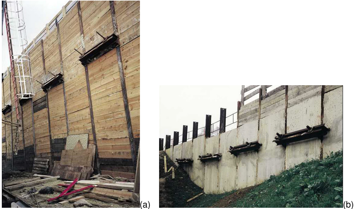
FIGURE 4.6 – Paroi berlinoise avec un parement de bastaings (a) pour un usage temporaire, ou de béton armé (b).
