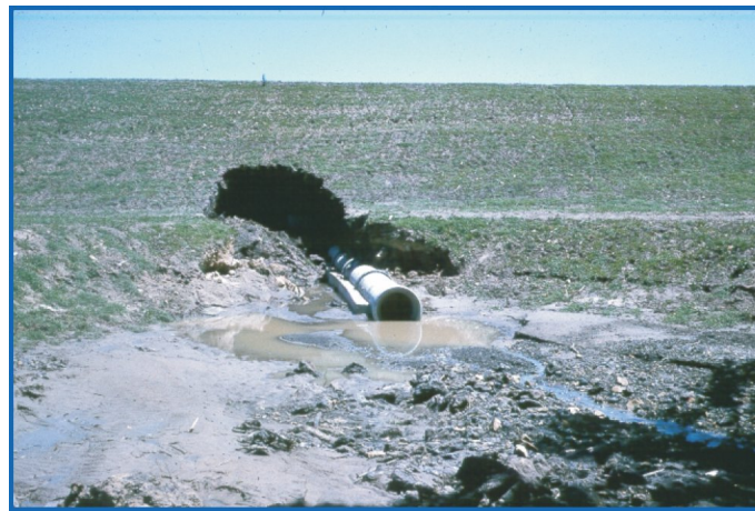
FIGURE 4.8 – Désordre causé dans un barrage en terre suite au développement d'un renard le long d'une conduite.
