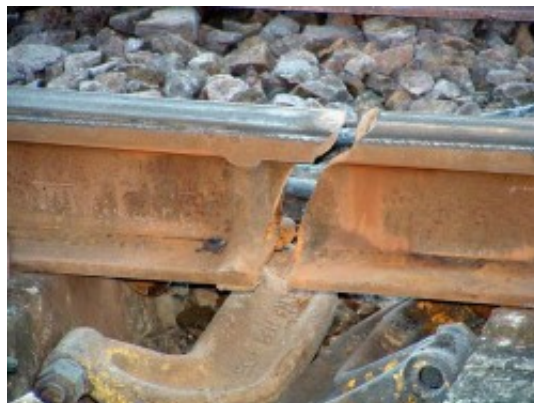
FIGURE 4.11 – Rupture d’un rail sur la ligne D du RER, de au gel en Octobre 2003
