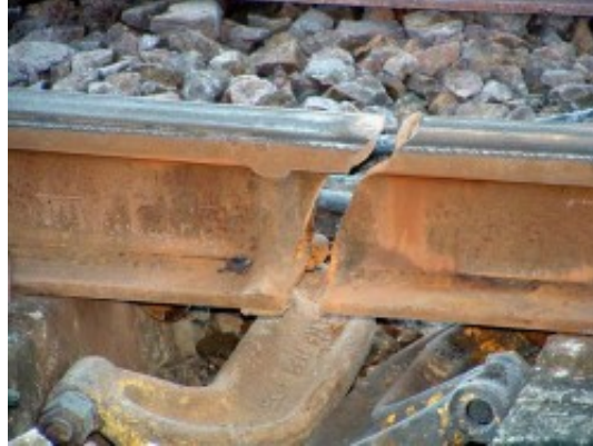
FIGURE 4.11 – Rupture d’un rail sur la ligne D du RER, de au gel en Octobre 2003
